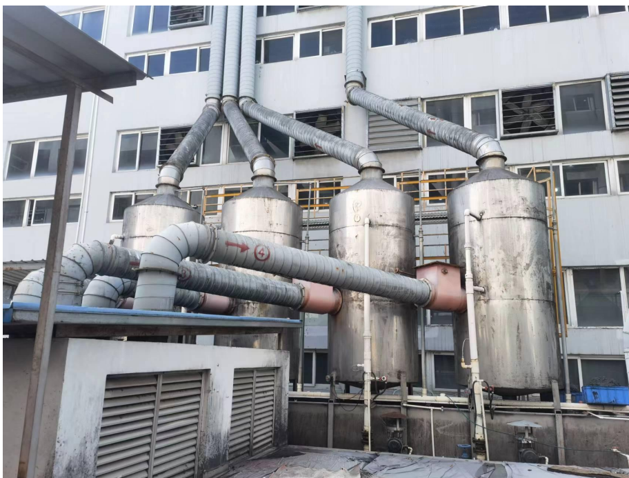
打磨废气净化处理设施DA002、DA003、DA004、DA005
