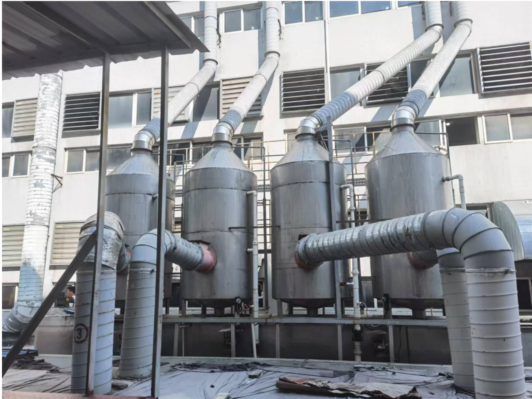
打磨废气净化处理设施DA006、DA007、DA008、DA009
